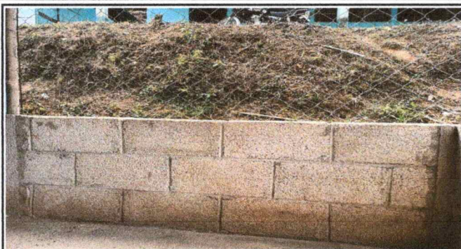
Foto 1. SE observa deterioro del muro perimetral
